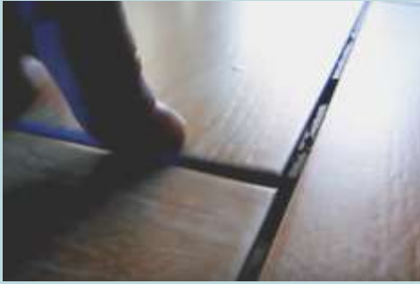
Отслоение и деформация кафельной плитки может свидетельствовать об утечке
